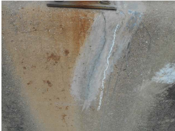
S2 방호벽 균열(0.3mm미만)
