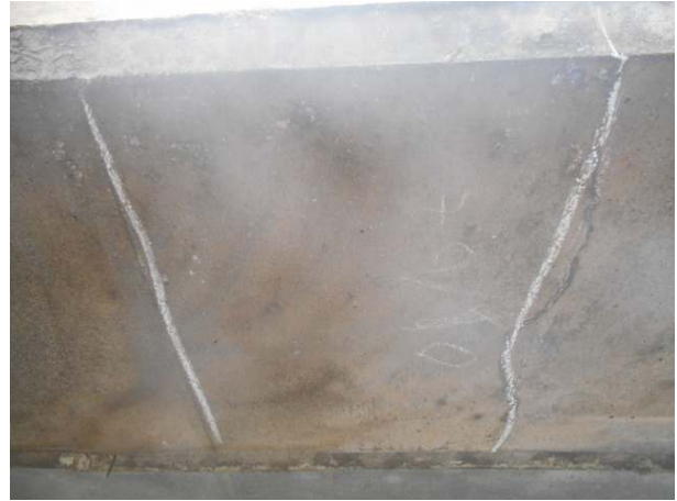
S2 캔틸레버부 균열(0.3mm미만)
