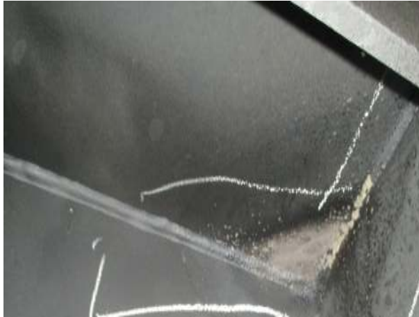
S2 G1-1 Steel Box 내부 도장 박리
