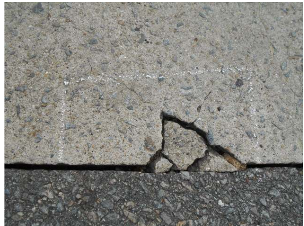
A2 후타재 파손
