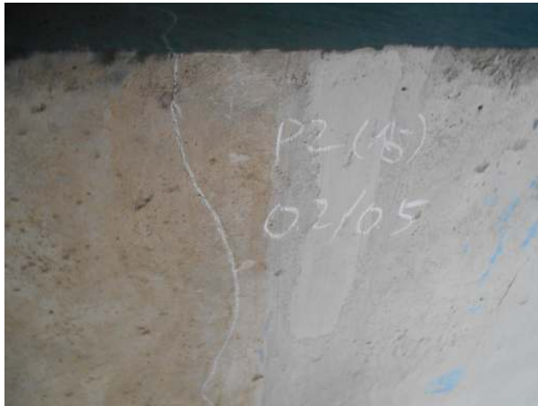
P2 교각 균열(0.3mm미만)
