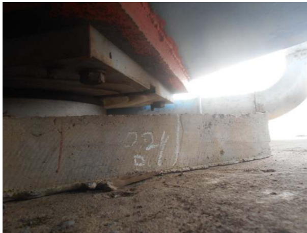
P1 Sh4 받침 Con'C 균열(0.3mm미만)
