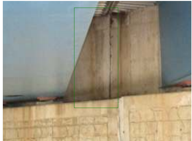
A1 교대 균열 및 백태
