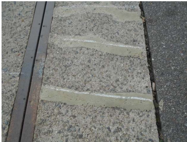
A1 후타재 균열(0.3mm미만)
