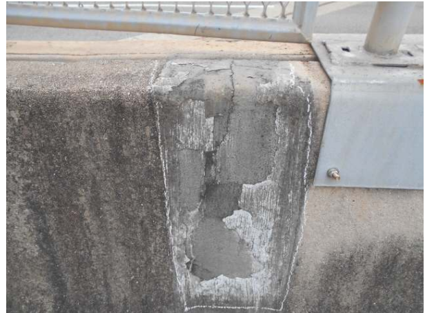
S3 방호벽 균열(0.3mm이상)
